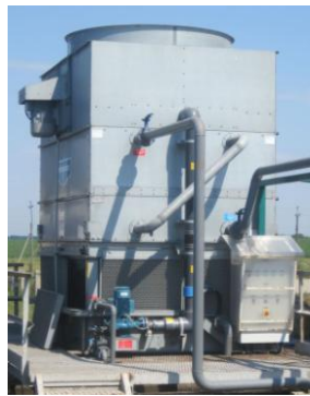
Рисунок 17 – Охолоджувач теплоносія станції ААВН-40/25 У1
