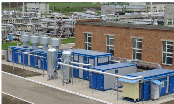
Рисунок 11 – Робота станції ААВН-40/25 У1 на Котельвському ГРП
